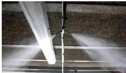
Feiner Wassernebel mittels Hochdruck-Sprühkühlungsanlage
